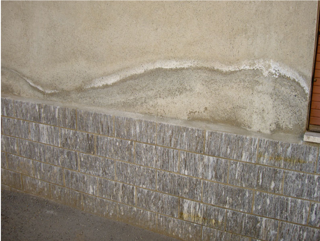
Il rivestimento della superficie inferiore della muratura mediante mattonelle di pietra non può arrestare il degrado dell'intonaco causato dall'umidità di risalita.
