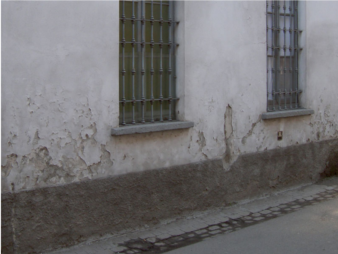
La strollatura della superficie inferiore della muratura non può arrestare il degrado dell'intonaco causato dall'umidità di risalita.
