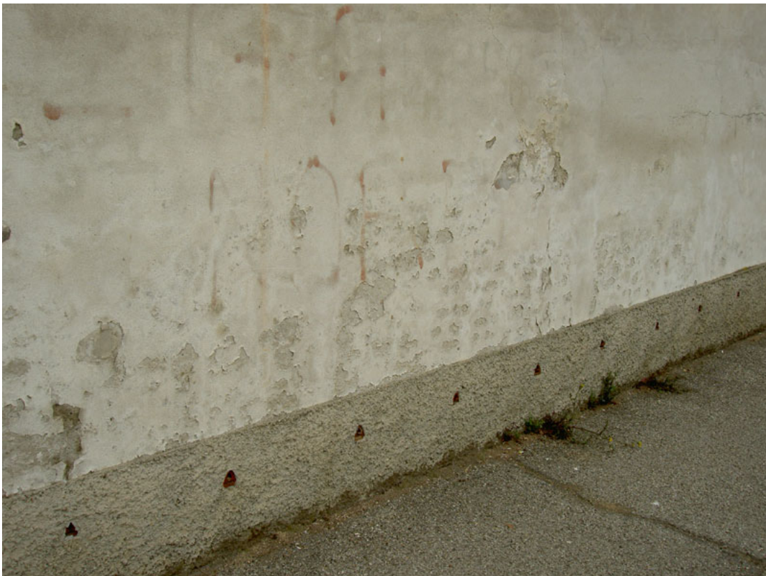
La strollatura della superficie inferiore della muratura e l'inserimento di fori di aerazione non possono arrestare il degrado dell'intonaco causato dall'umidità di risalita.
