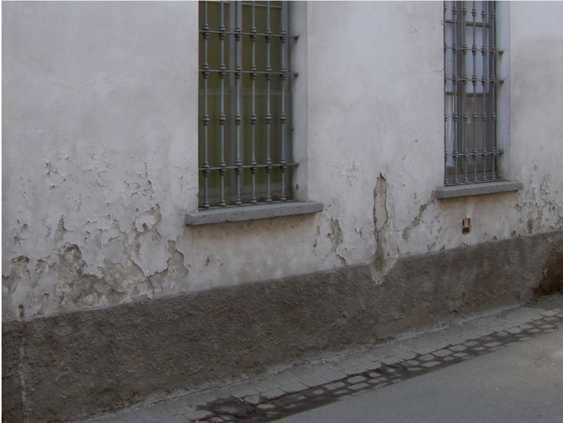
La strollatura della superficie inferiore della muratura non può arrestare il degrado dell'intonaco causato dall'umidità di risalita.
