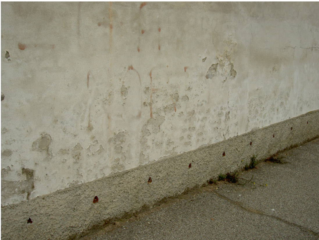
La strollatura della superficie inferiore della muratura e l'inserimento di fori di aerazione non possono arrestare il degrado dell'intonaco causato dall'umidità di risalita.
