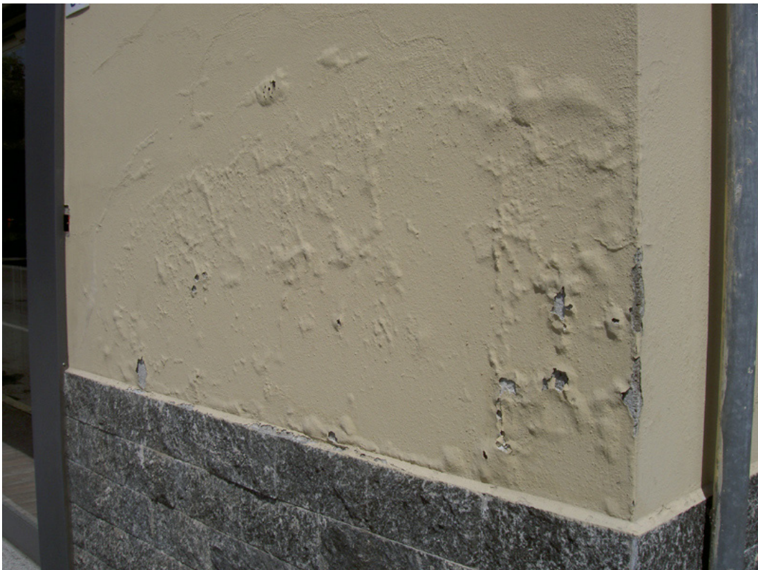
Il rivestimento della superficie inferiore della muratura mediante mattonelle di pietra non può arrestare il degrado dell'intonaco causato dall'umidità di risalita.
