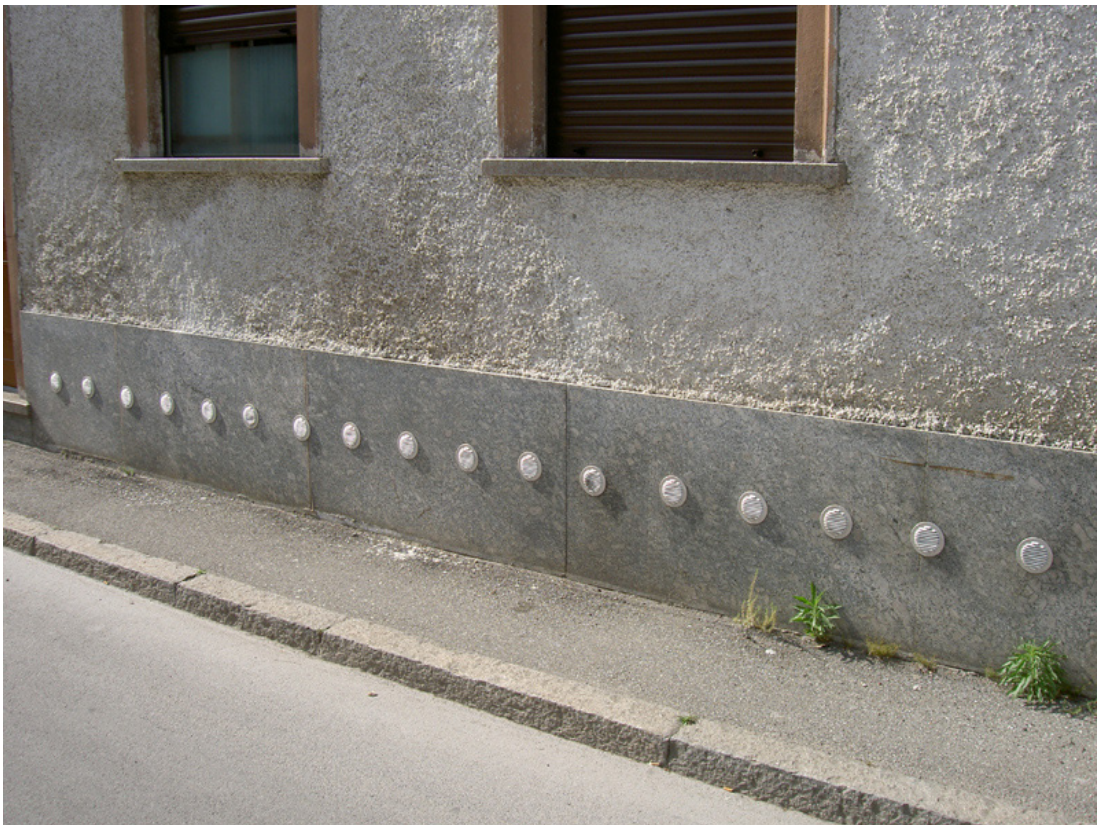
Il rivestimento della superficie inferiore della muratura mediante lastre di marmo e l'inserimento di fori di aerazione non possono arrestare il degrado dell'intonaco causato dall'umidità di risalita.
